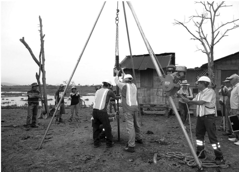
Figura 2. Utilización del equipo de obtención de testigos de suelo por percusión, localidad Charapotó.
